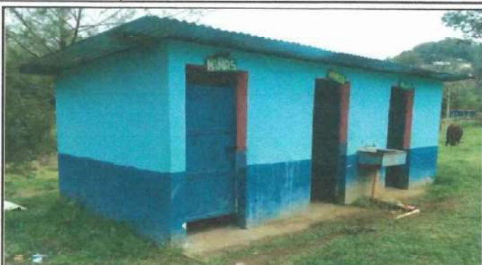
Foto 2: Se observa la oxidación provoca la urgencia del cambio de láminas, así como también las puertas necesitan mantenimiento.
