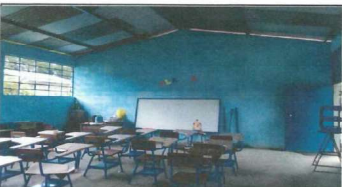
Foto 4: Se ve muy bien que la pared tien humedad por falta de repello por fuera y a la ves urge pintar el aula. Asimismo tanto el techo como su estructura no están seguras para atender a los niños.
