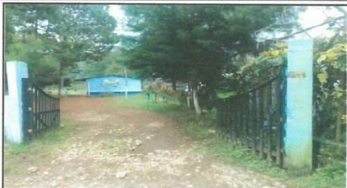
Foto 1: Se observa que urge el cambio de porton de madera a metal, por su deterio y mal estado, asimismo a las columnas necesitan repello y cenillado, para impedir que personas ajenas ingresen a las instalaciones de la escuela.
