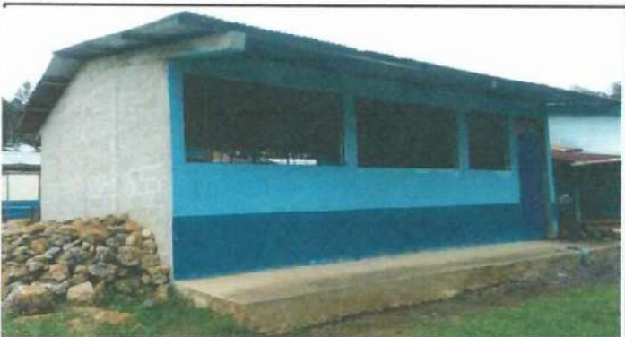
Foto 3: Se observa cuando llueve y hay viento las brisas penetran dentro del aula, y por la falta de repello el block se humedece cuando llueve.
